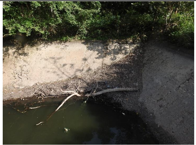
說明：工程預計於此處設置由既有道路至池底的施工便道，邊坡為混凝土組成，斜度約為 1:2。
