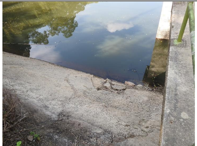
說明：給水塔工作橋側邊坡有兩處破損，工程預計使用與現況相同材質-混凝土填補，減少蓄水滲漏情形。
