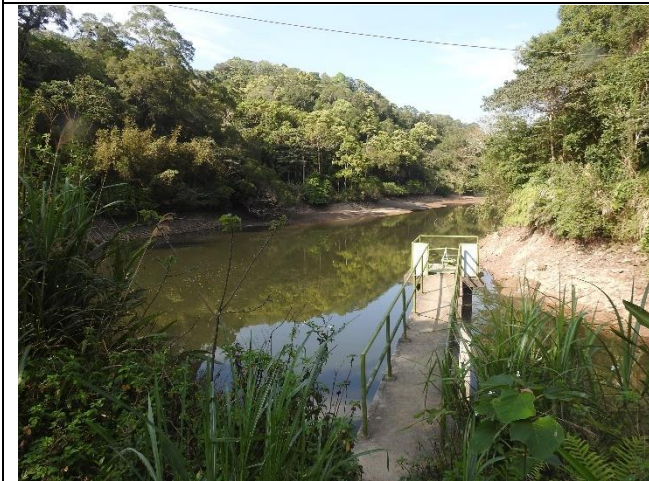
說明：給水塔工作橋現況已傾斜，工程預計於底部增加 4 支經防鏽處理的鋼構支撐，保護作業人員安全。
