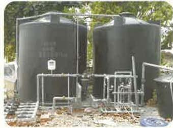
◀ 調節控制設施
